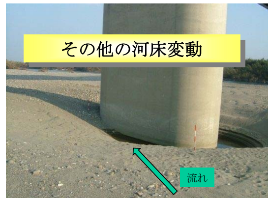
橋脚周辺の局所洗掘
