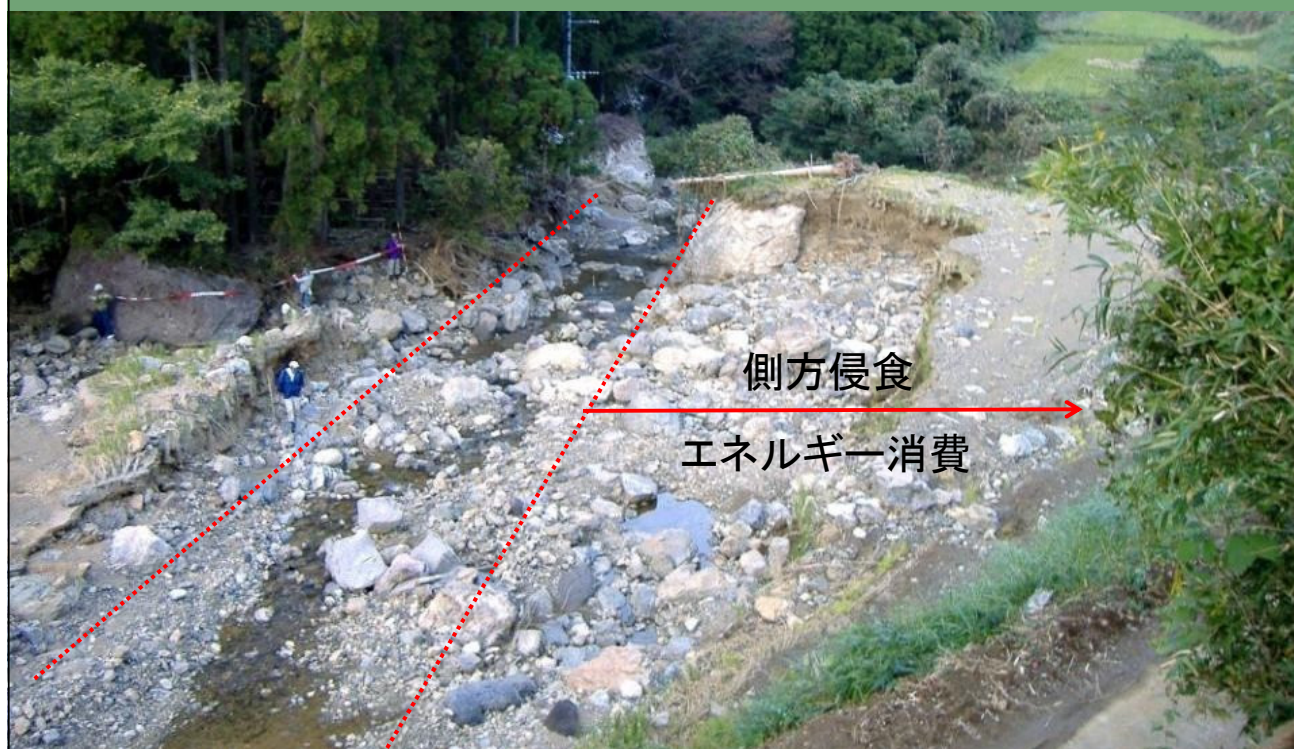
山附川(宮崎県)／平成17年9月6日台風14号による被災
