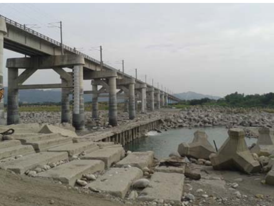
写真-3 鉄道橋の直下流の局所洗掘状況
