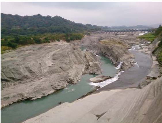
写真-2 異常侵食状況 (石岡堰直下流)
