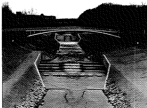
実際の落差工
