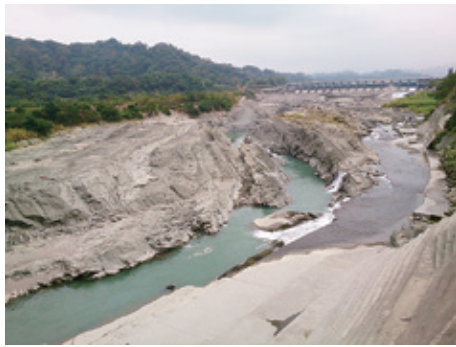
写真3 異常侵食状況（石岡堰直下流）
