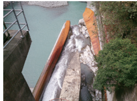
写真1 排砂ゲートの摩耗(天輪ダム)
