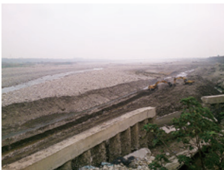
写真6 護岸の侵食と崩壊の状況
