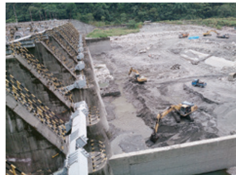
写真2 ダム直下の異常堆積(馬鞍ダム)
