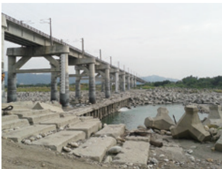
写真5 鉄道橋の直下流の局所洗掘状況
