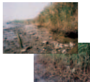
写真—2 ヨシ原地盤が洗掘された 状況(上)根茎が露出した状況(下)
