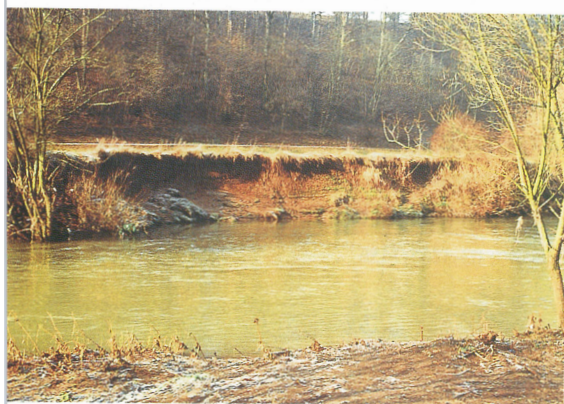
図-2 用地の取得後は、崩壊した川岸をそのままにしておくことができる
