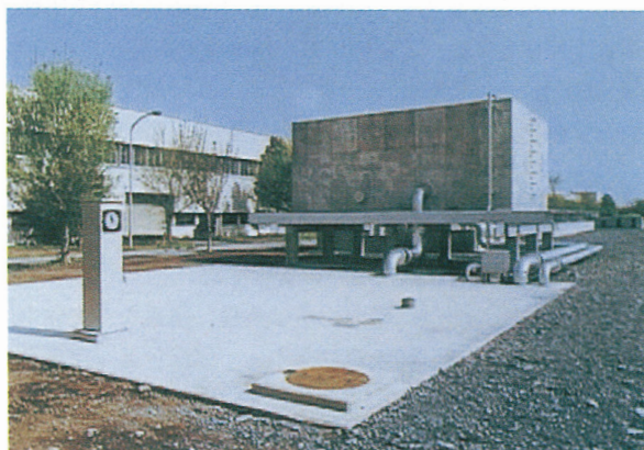
写真2 地下貯水槽、高水槽
