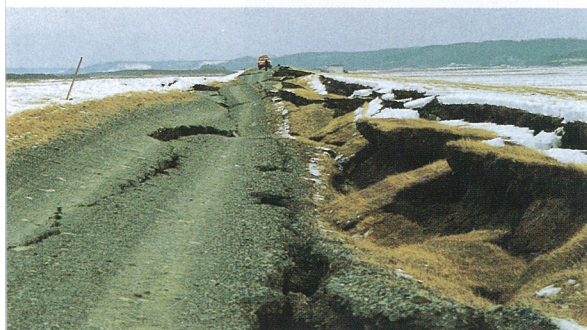
釧路沖地震・堤防被災状況 平成5年1月15日発生（十勝川）
