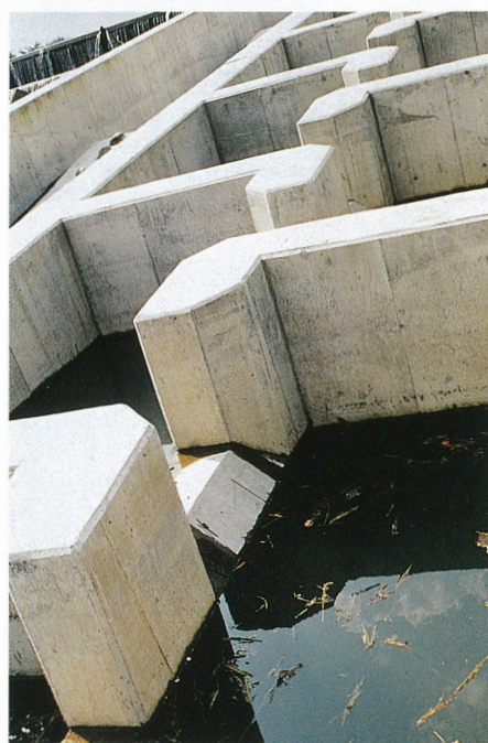
写真-3 モデル事業第一号の魚道。多摩川四ツ谷本宿堰。アイスハーバー式と粗石付斜曲面式のハイブリットタイプの魚道
