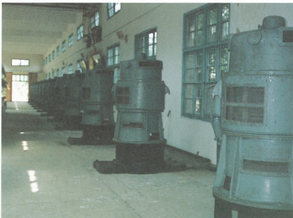
写真-1 江都水利センターのポンプ場
