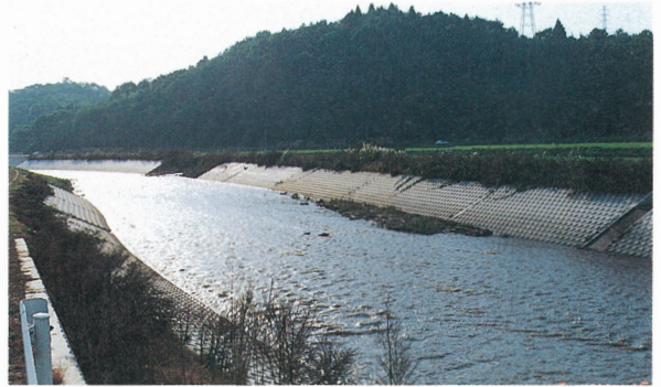
写真-4 出水後(全景)
