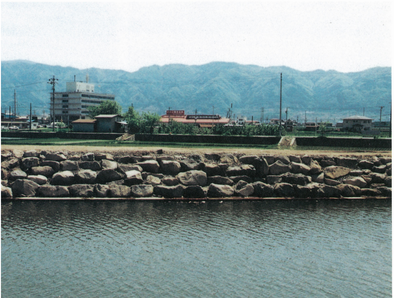
写真-1 護岸の大きさが少し大きすぎると思われる
