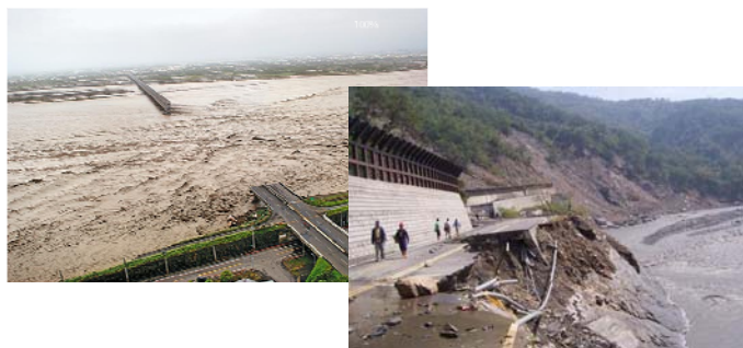
八八水災による被害の状況
