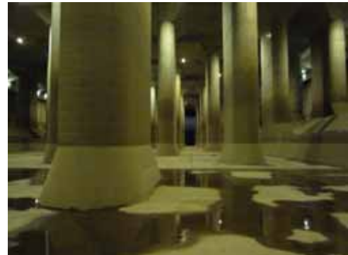
写真 8 ポンプ室横の調圧水槽
