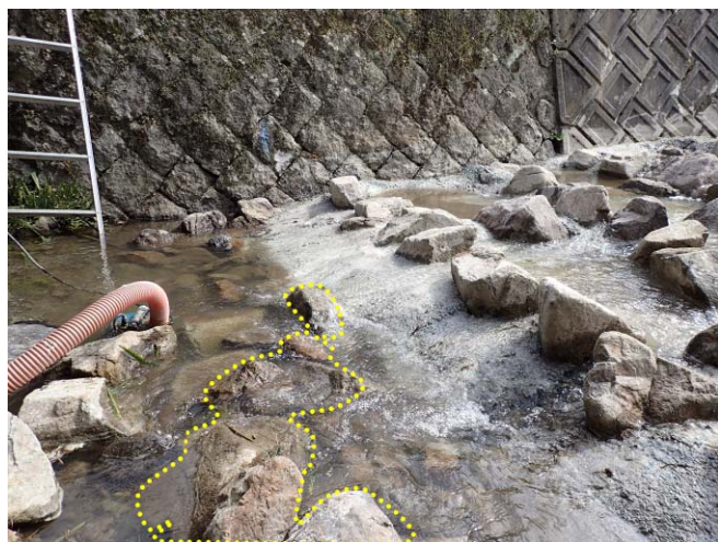
図3 魚道末端部と現河床との擦り付け部の落差 (点線部：魚道末端部に追加した礫、プールができている)
