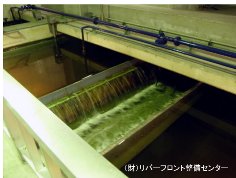
下水道整備による水質浄化（日本）
