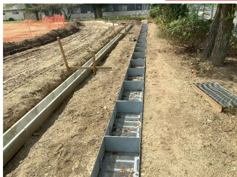
浸透緑溝 ←グラウンドの水を浸透（南陵高校に設置中）
