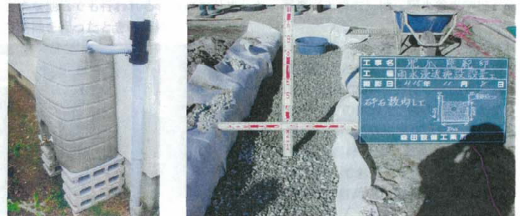
(雨水貯留タンク)
